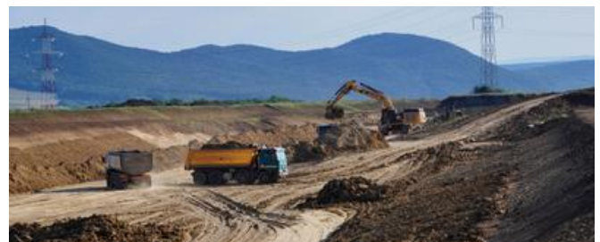
Ein 220 kV Strommast direkt in der Mitte der Autobahn musste umgelegt werden. Bild: PORR AG
