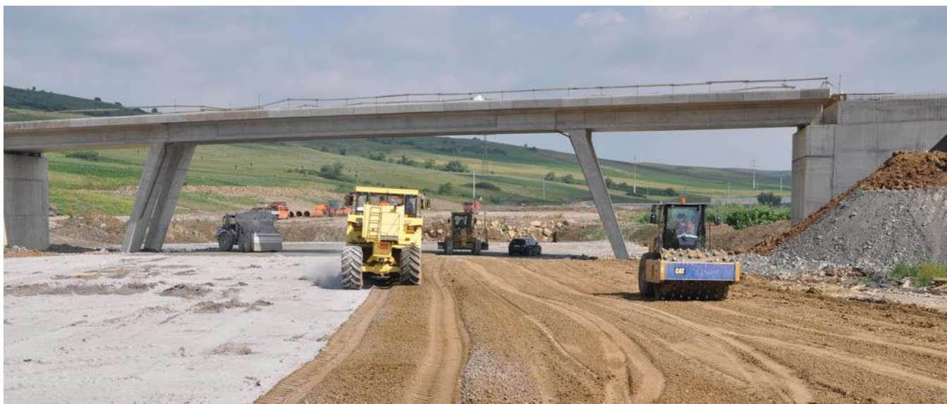
Ein Teil des Schüttmaterials musste zusätzlich mit Zement stabilisiert werden. Bild: PORR AG
