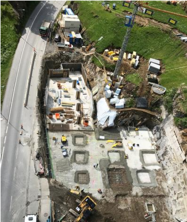
Die Erdbauarbeiten wurden aufgrund unterschiedlicher Bodenbeschaffenheiten zu einer aufwendigen Aufgabe. Bild: PORR AG
