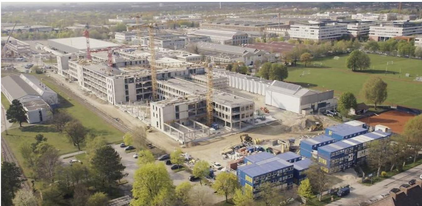
Auf einer Fläche von ca. 19.700 m 2 bebauter Fläche entstand der neue Bürokomplex. Quelle: PORR
