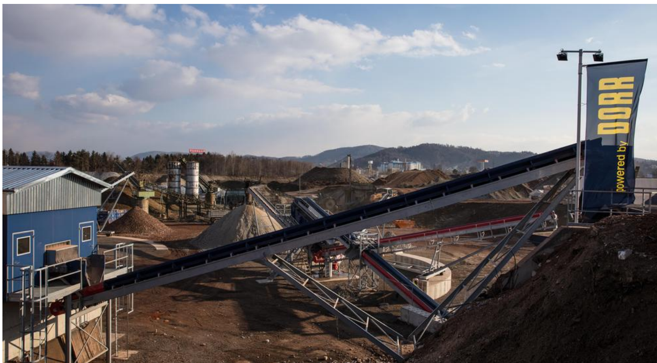
Die Recyclinganlage Pirka wurde in nur 6 Monaten Bauzeit errichtet. Quelle: Daniel Ulbricht-Sundt
