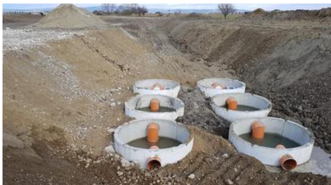
Im zweireihigen Ölabscheidersystem wird das Wasser gereingt. Quelle: PORR Construct
