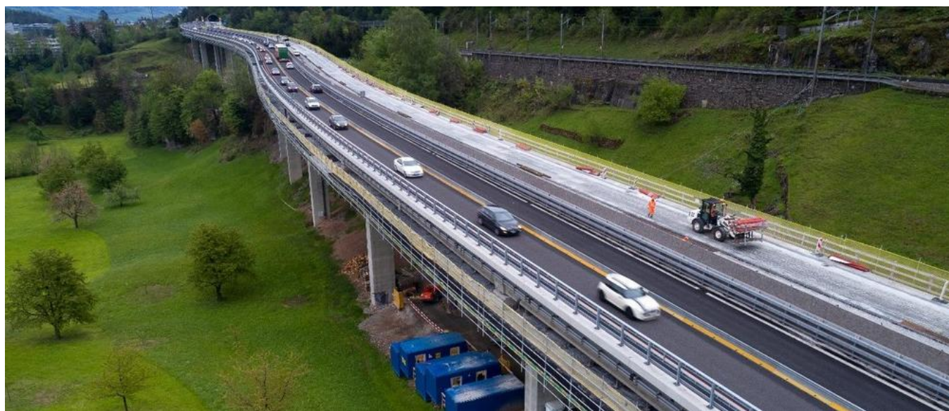
Die Brücke Linden mit seitlichem Untersichtgerüst und neuem Konsolkopf. Quelle: PORR AG
