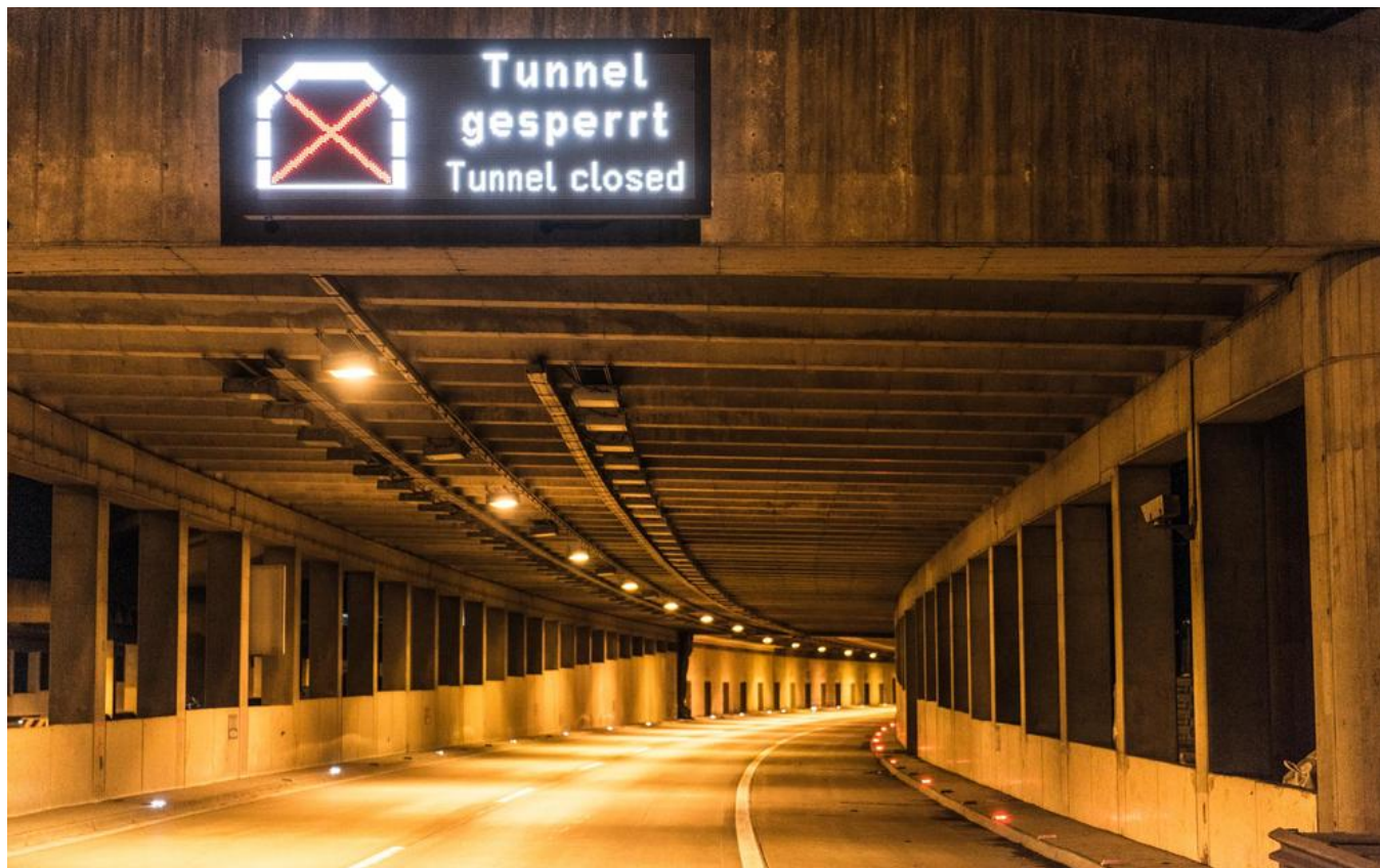
Die Nachtsperren von 20 Uhr bis 5 Uhr ermöglichten eine Nettoarbeitszeit von gerade einmal sechs Stunden. In diesem Zeitfenster musste ein ganzer Abschlag durchgeführt werden. Quelle: Thomas Exel
