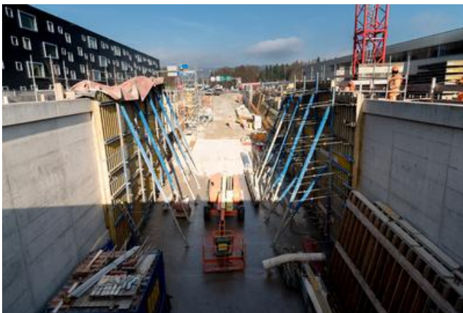
Die Rampe Hero während der Ausführungsphase der Rampenwände im November 2019. Quelle: PORR
