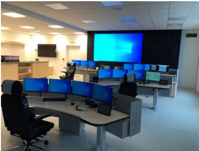
Unter der Anlagenwarte befindet sich ein erdbebensicherer Doppelboden. Quelle: PORR
