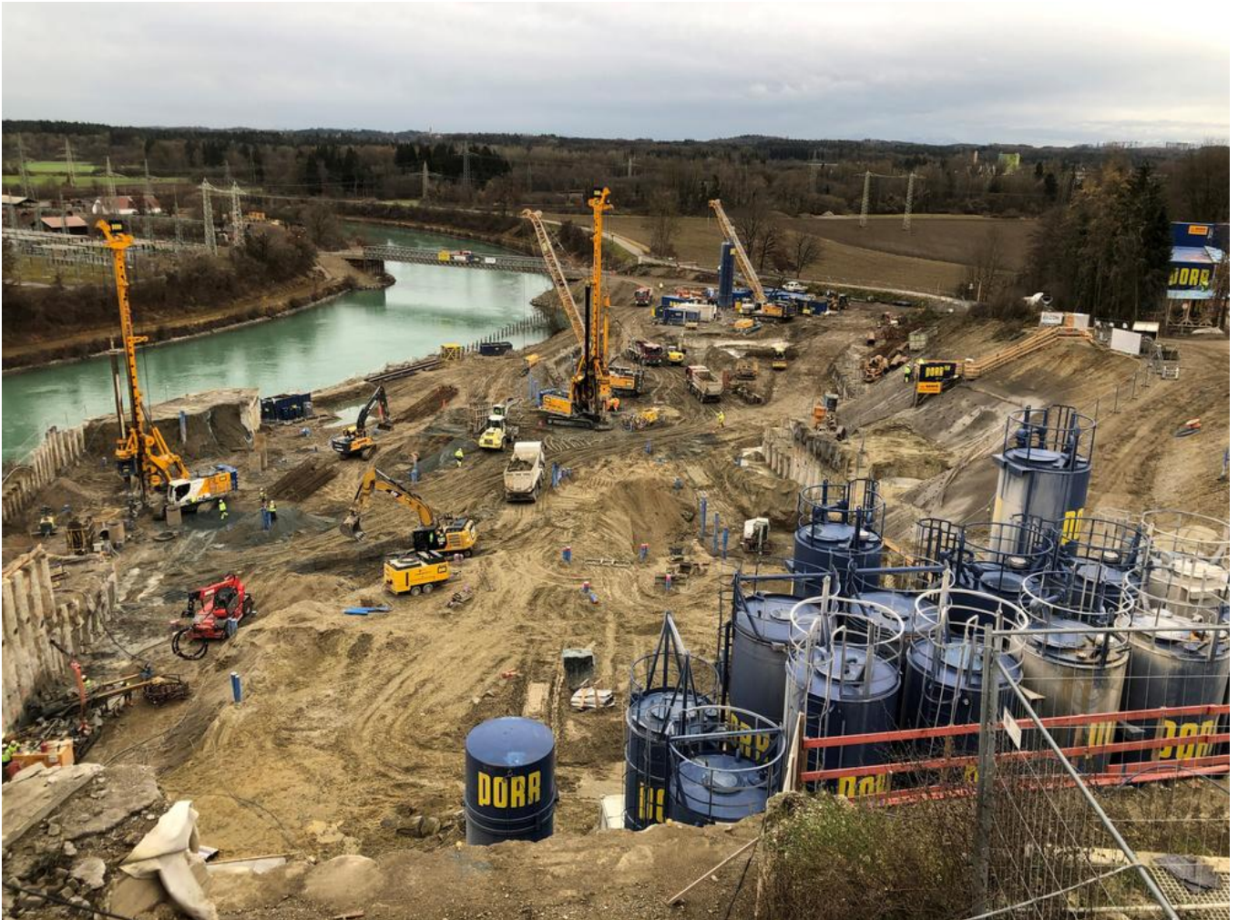
Bei der Errichtung der Baugrube für das Kraftwerk Töging konnte die PORR beim Auftraggeber Verbund mit zahlreichen Optimierungen gegenüber den ursprünglichen Plänen punkten. Quelle: Thomas Wiczorek
