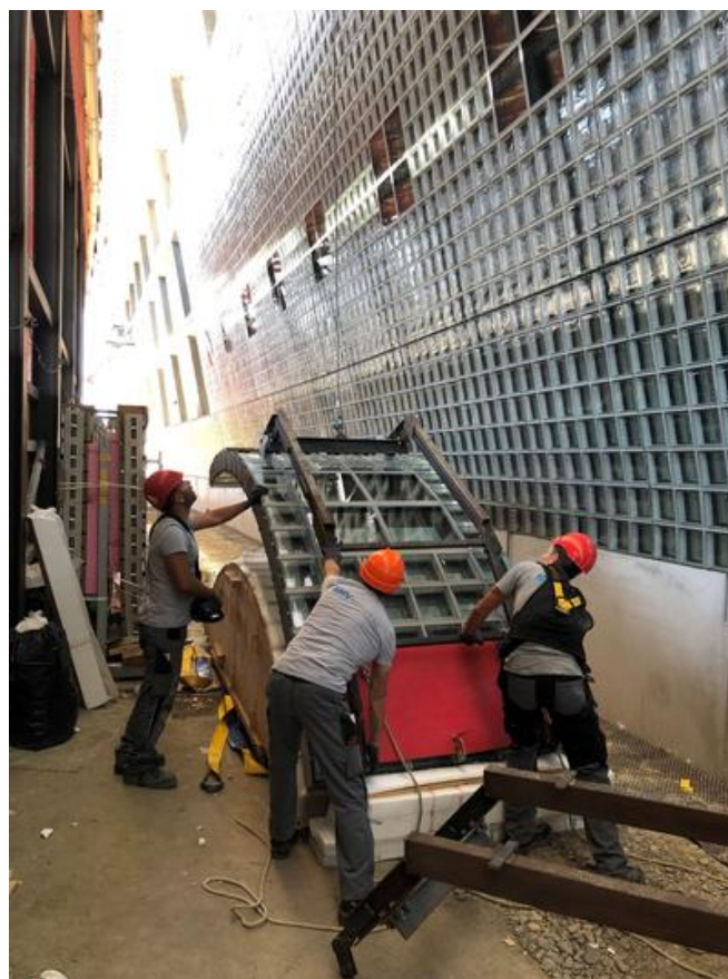
Das Einheben der Elemente wurde aufgrund der beengten Platzverhältnisse zu einer echten Herausforderung. Quelle: PORR
