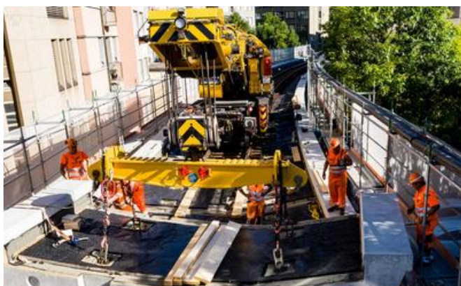
Auf ein bestehendes Viadukt wurde eine neue Fahrbahn mit Betonelementen verlegt. Quelle: PORR
