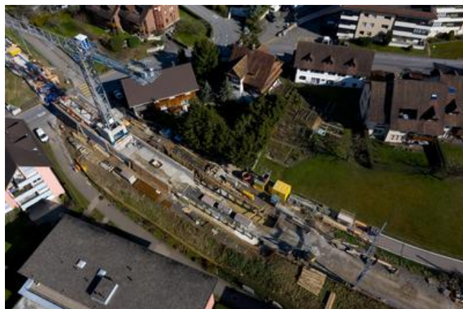
Das äußerst beengte Umfeld stellte enorme Anforderungen an die Logistik. Quelle: PORR
