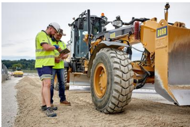
Der Bau der Umfahrung Wieselburg wird von zahlreichen Maßnahmen zum Schutz von Mensch und Umwelt begleitet. Quelle: PORR
