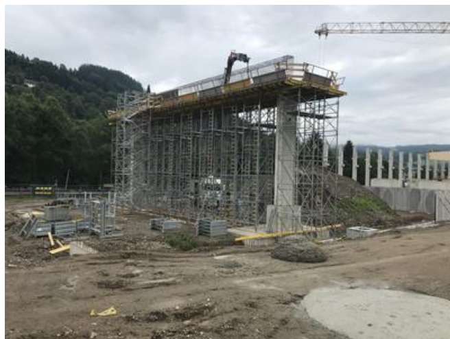
Aufgrund des hohen Eigengewichts mussten die Träger anders als in der Ausschreibung vorgesehen in Ortbetonbauweise hergestellt werden. Quelle: PORR
