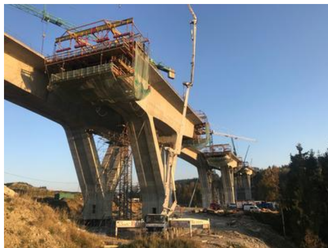
Mit Hilfe von Schiebevorrichtungen wurden die einzelnen Segmente der Brücke betoniert. Quelle: PORR
