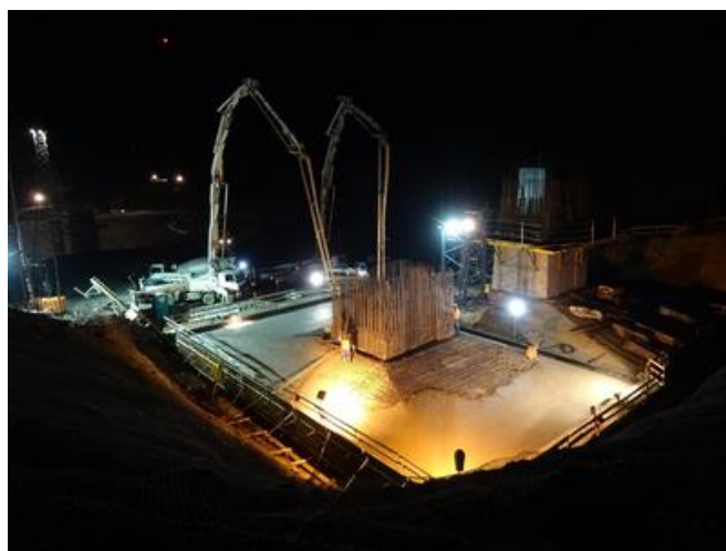
In jedem Brückenfundament wurden 226 t Betonstahl und 1.200 m 3 Beton verbaut. Quelle: PORR
