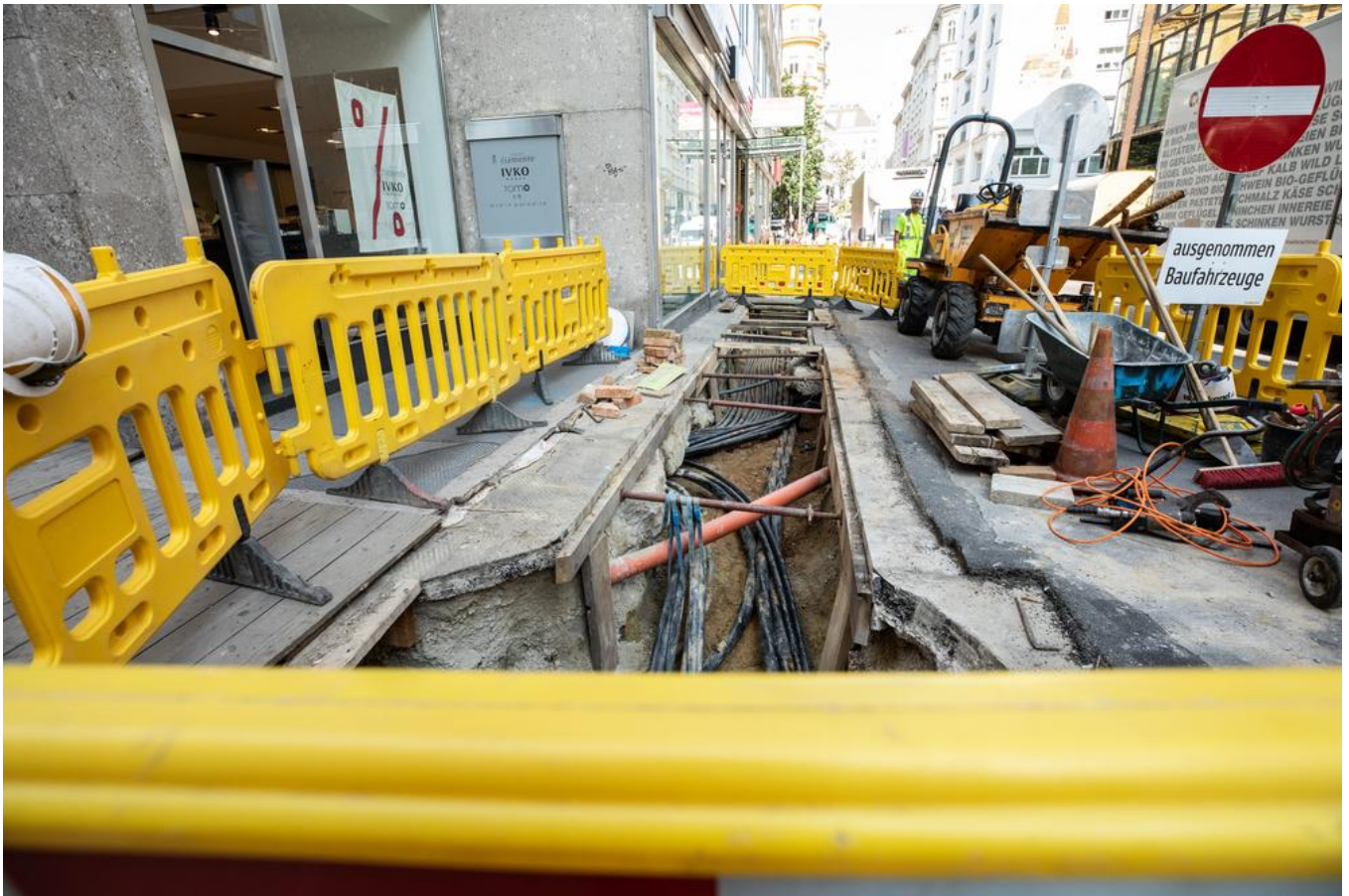
Das beengte Baustellenumfeld stellte das Team der WIBEBA vor einige Herausforderungen. Quelle: PORR
