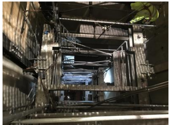
Für den sicheren Ausbau der Stahlteile hat die PORR ein 560 m 3 großes Raumgerüst errichtet. Quelle: PORR
