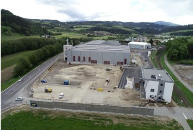
Der Einbau von 10.000 t Asphaltmischgut im Zuge der Errichtung der Außenanlage wurde zur logistischen Herausforderung. Quelle: PORR
