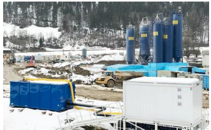
Bodenluftabsauganlage (blauer Container) mit provisorischer Abgasleitung während des Baustellenbetriebs. Bild: PORR Umwelttechnik GmbH
