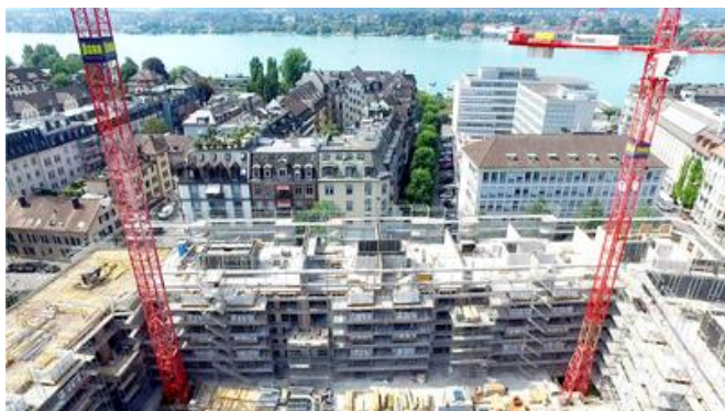
In den Obergeschossen setzt die PORR auf einen Mix klassischer tragender Außenwandkonstruktionen. Bild: PORR AG
