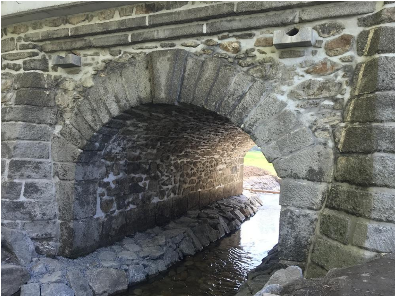
Die Fugensichtflächen wurden weder geglättet noch anderweitig bearbeitet. Fehlendes Natursteinmauerwerk wurde mit Bruchstein ergänzt. Quelle: PORR
