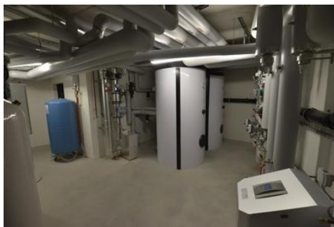
Auch in der Technikzentrale setzen Bauherr und Ausführende auf höchste Qualität. Quelle: PORR AG
