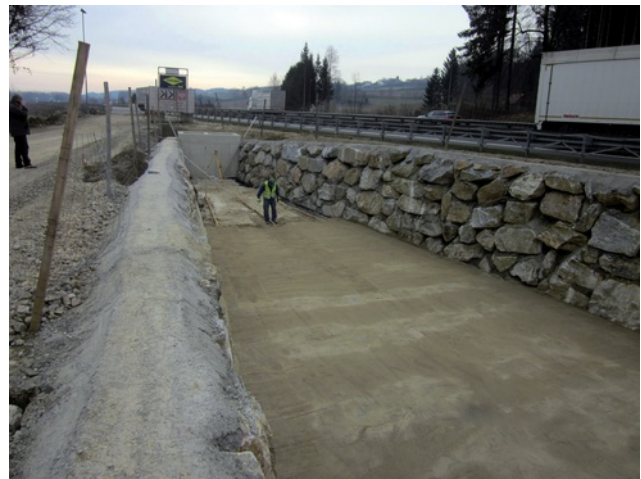
Rückhaltebecken Bild: PORR
