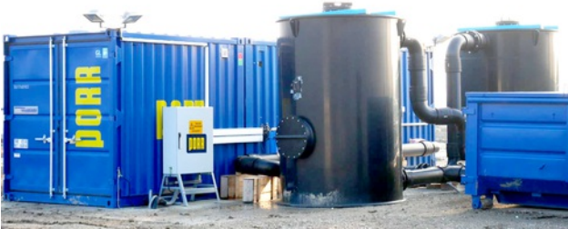
Containerausführung der Absauganlage (v.l.n.r.): Steuerungs- und Maschinencontainer, Aktivkohlefilter(schwarz) und Biofiltern (niedriger blauer Abrollcontainer) Bild: PORR AG
