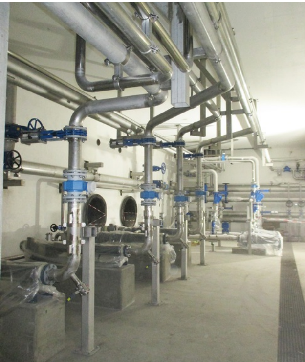
Neue Pumpen und Rohrleitungen für die erweiterte Schlammbehandlung. Bild: PORR AG
